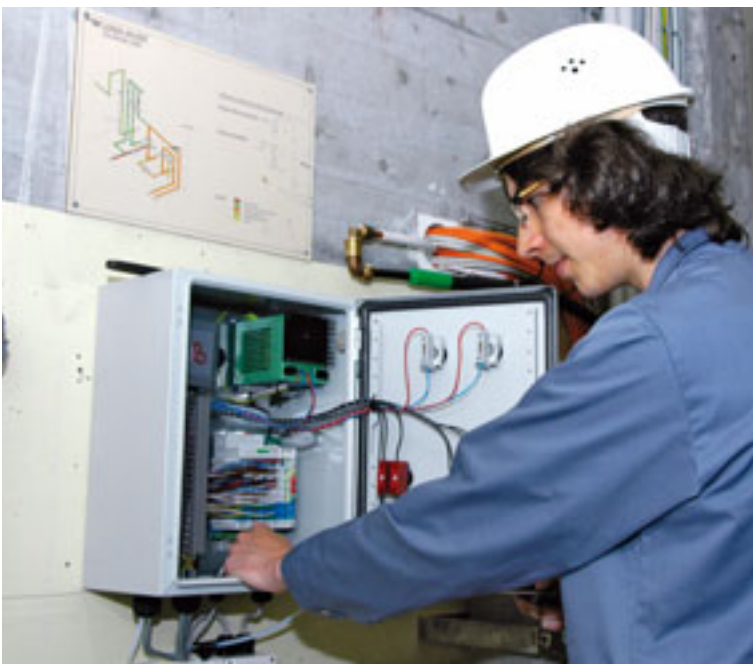
Inbetriebsetzung der Steuerung im Kühlraum des Serverraums.
